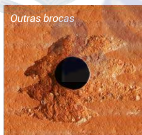
Saída do furo danificada.
